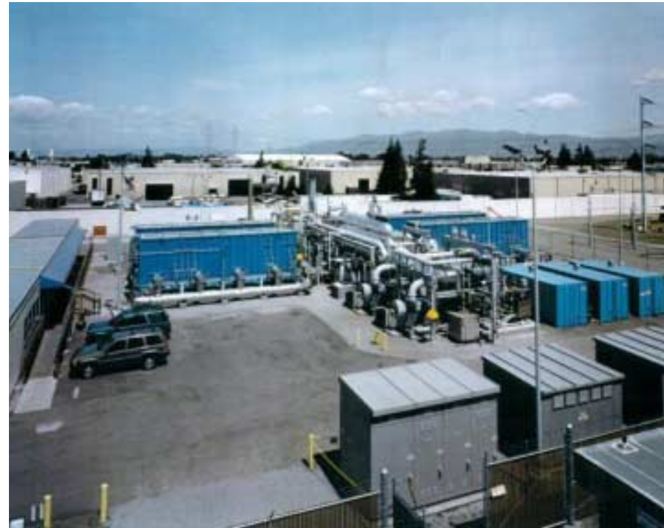
MCFC-Anlage der Firma "ERC" als HKW in Santa Clara (USA) (2 MW el , Abwärme 450°C)
