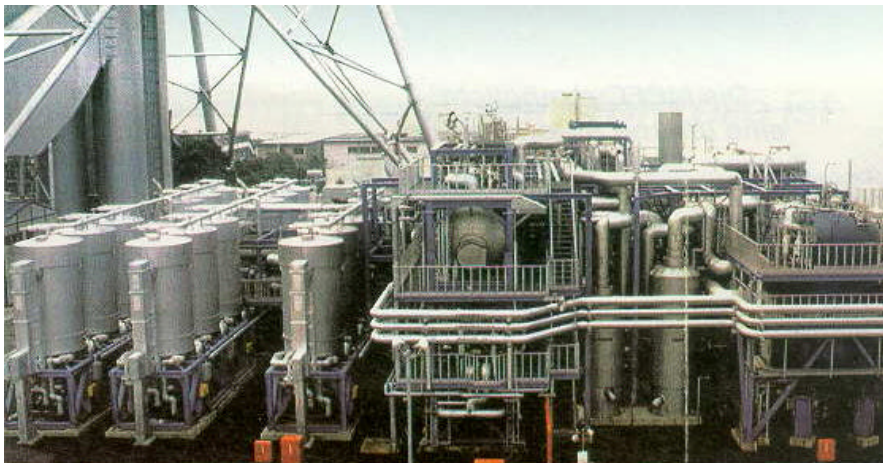
Bild 5: PAFC-Kraftwerk in Tokio (Leistung 11 MW e )
