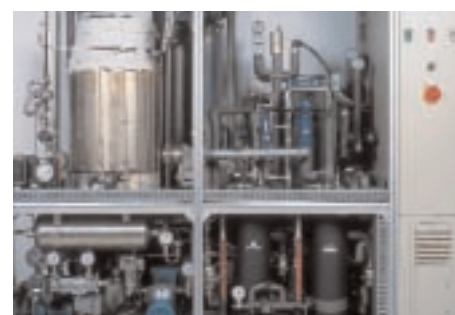
Demonstrationsanlage für ein Brennstoffzellen-BHKW.
