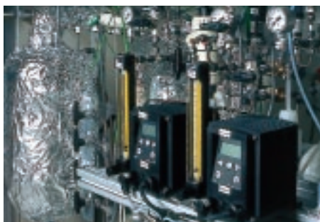
Kerosin-Reformer für eine oxidkeramische Brennstoffzelle (SOFC) mit einer Leistung von 25 kW und integrierter Entschwefelung.
