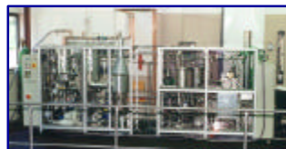
BZ-Hausenergieversorgung zur Aus- und Weiterbildung (ZSW)
